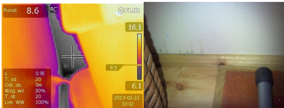
Fot. 10 Spizarka: kondensacja pary wodnej w narożniku.
