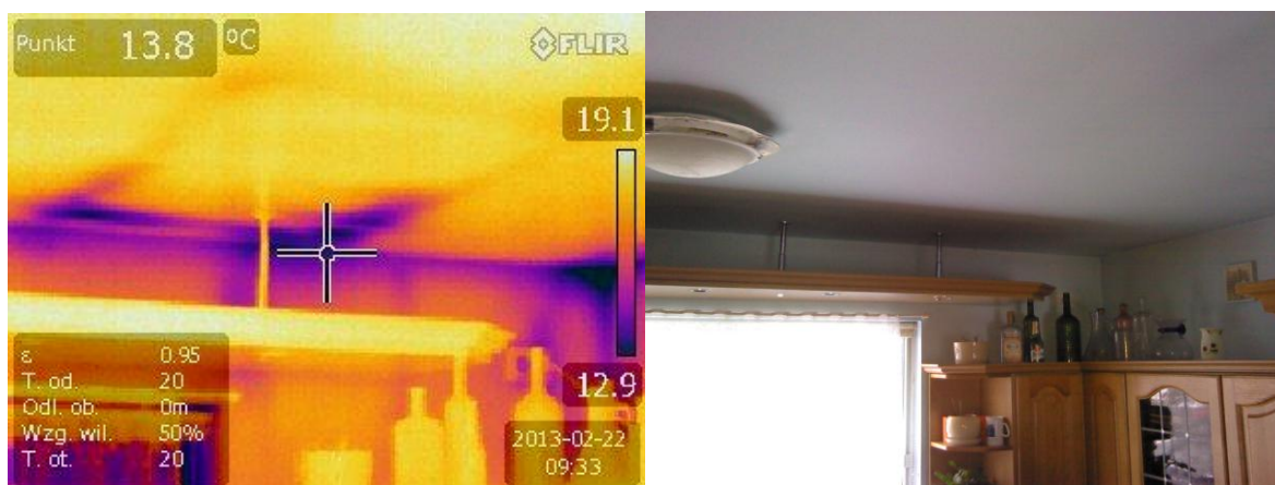
Fot. 4 Kuchnia: mostki termiczne wzdłuż górnego pasa stężającego.
