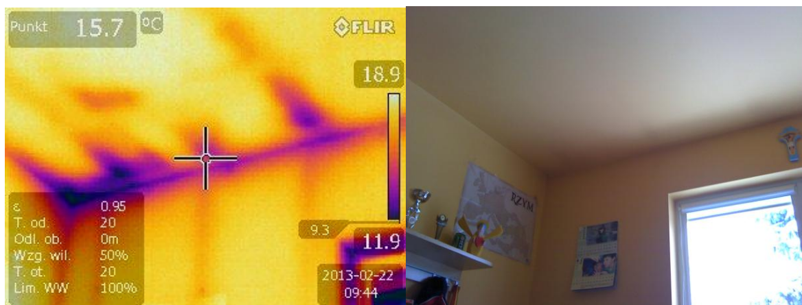
Fot. 6 Mostki termiczne w narożniku pokoju oraz na połączeniach pasów dźwigarów z górnym pasem stężającym.
