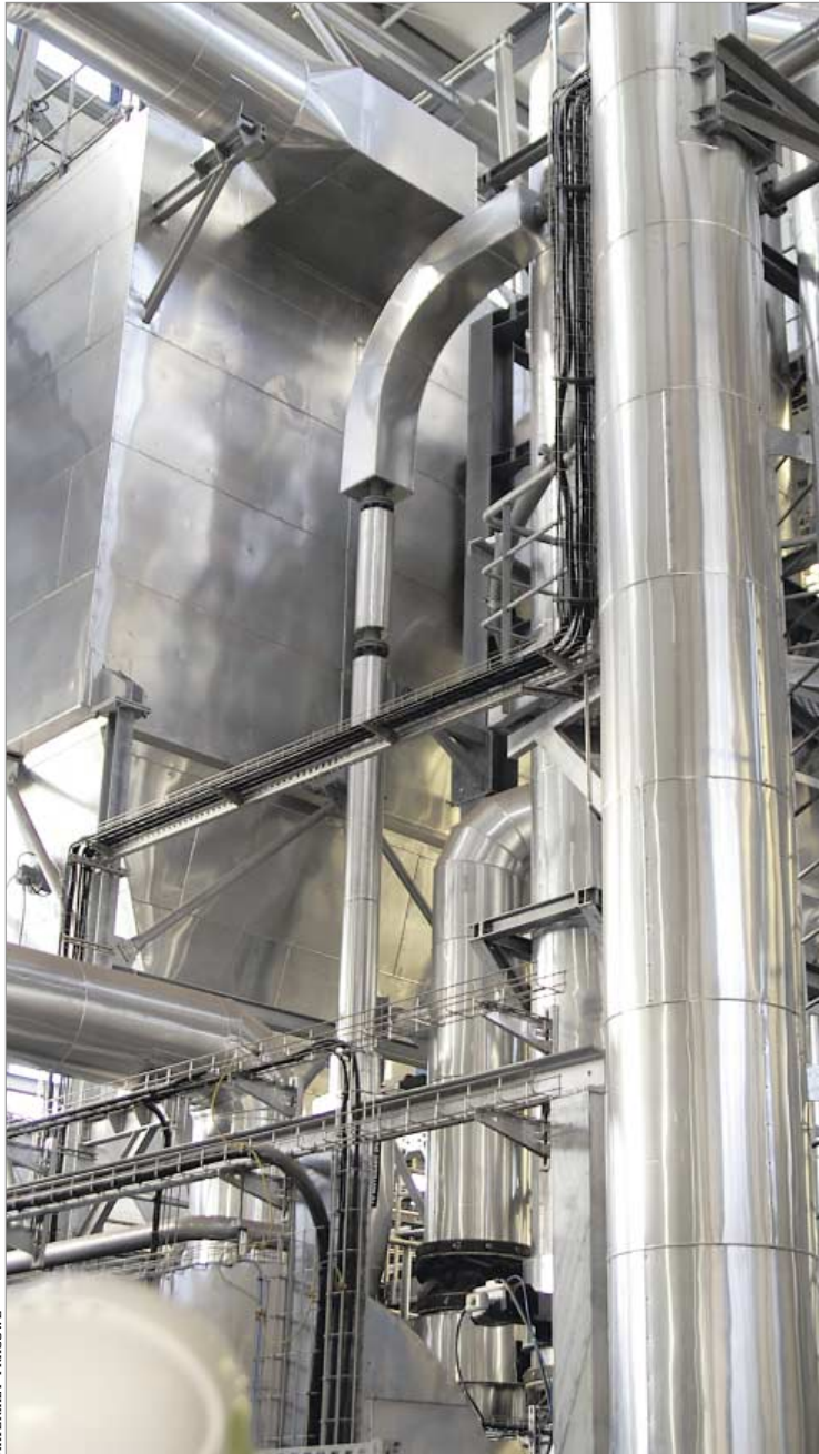
♦ Fragment wewnętrznej instalacji technologicznej Stacji Termicznej Utylizacji Osadów Ściekowych (STUOŚ)
